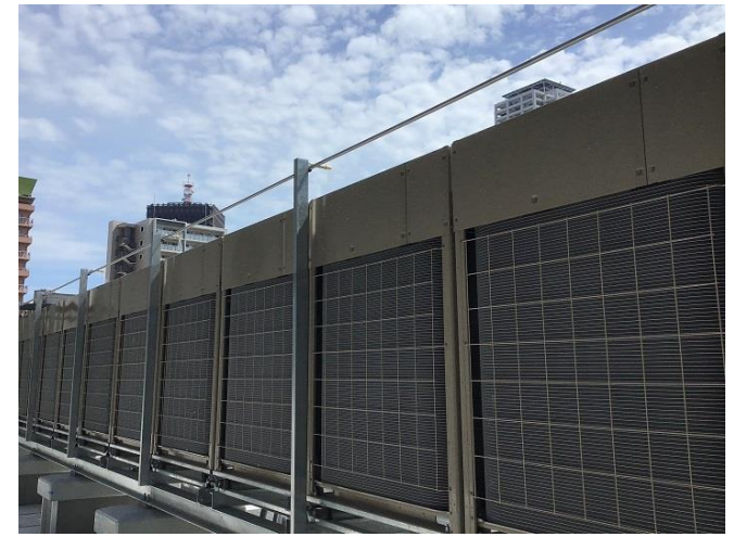
磯上体育館室外機ミスト 2022
